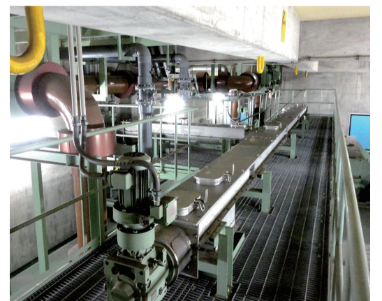
国内で設計・製造されたスクリーアは片持ち構造で、32mまで1台の装置で搬送することが可能。こちらは八戸下水処理場に設置された製品。
