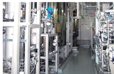
医薬用精製水供給装置
